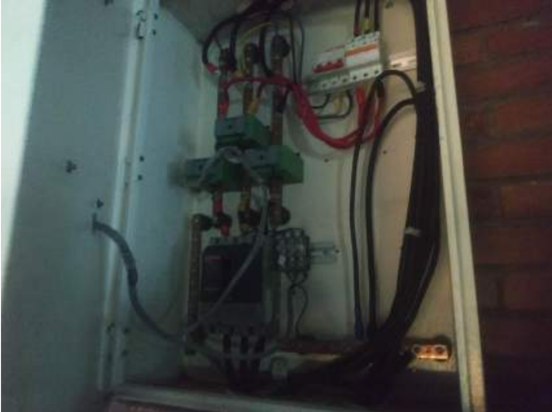
Kabel Power Plaza Umar Kayam sudah dengan kabel yang lebih besar
