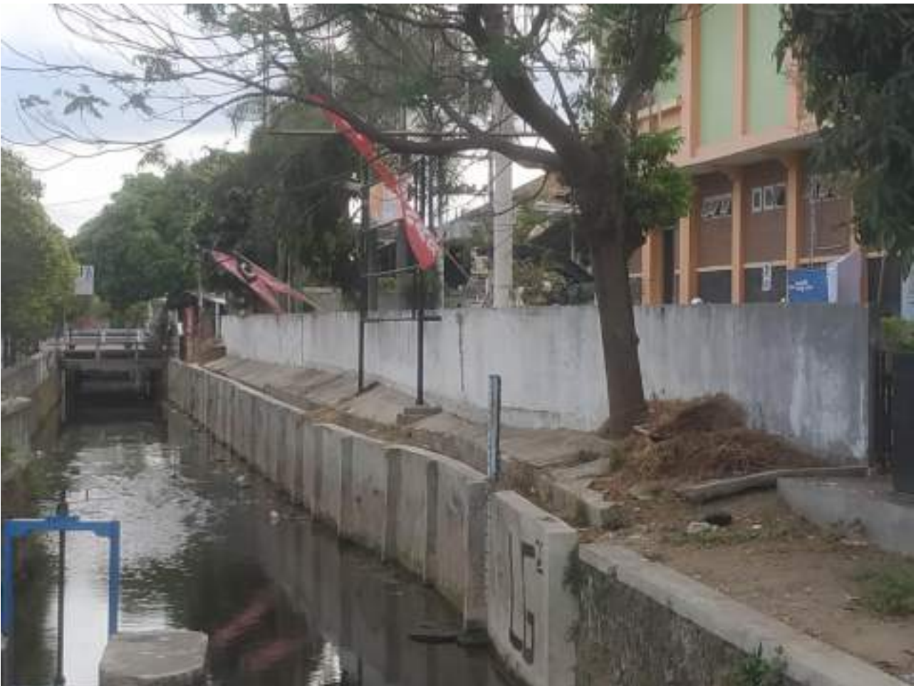
Kondisi cat pagar tembok selatan yang perlu dilakukan pengecatan ulang
