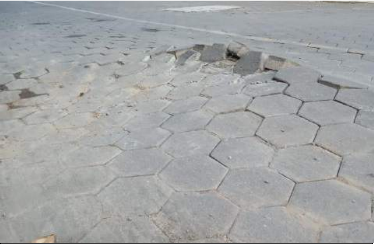
Kondisi paving blok timur Plaza Umar Kayam sebelum diperbaiki
