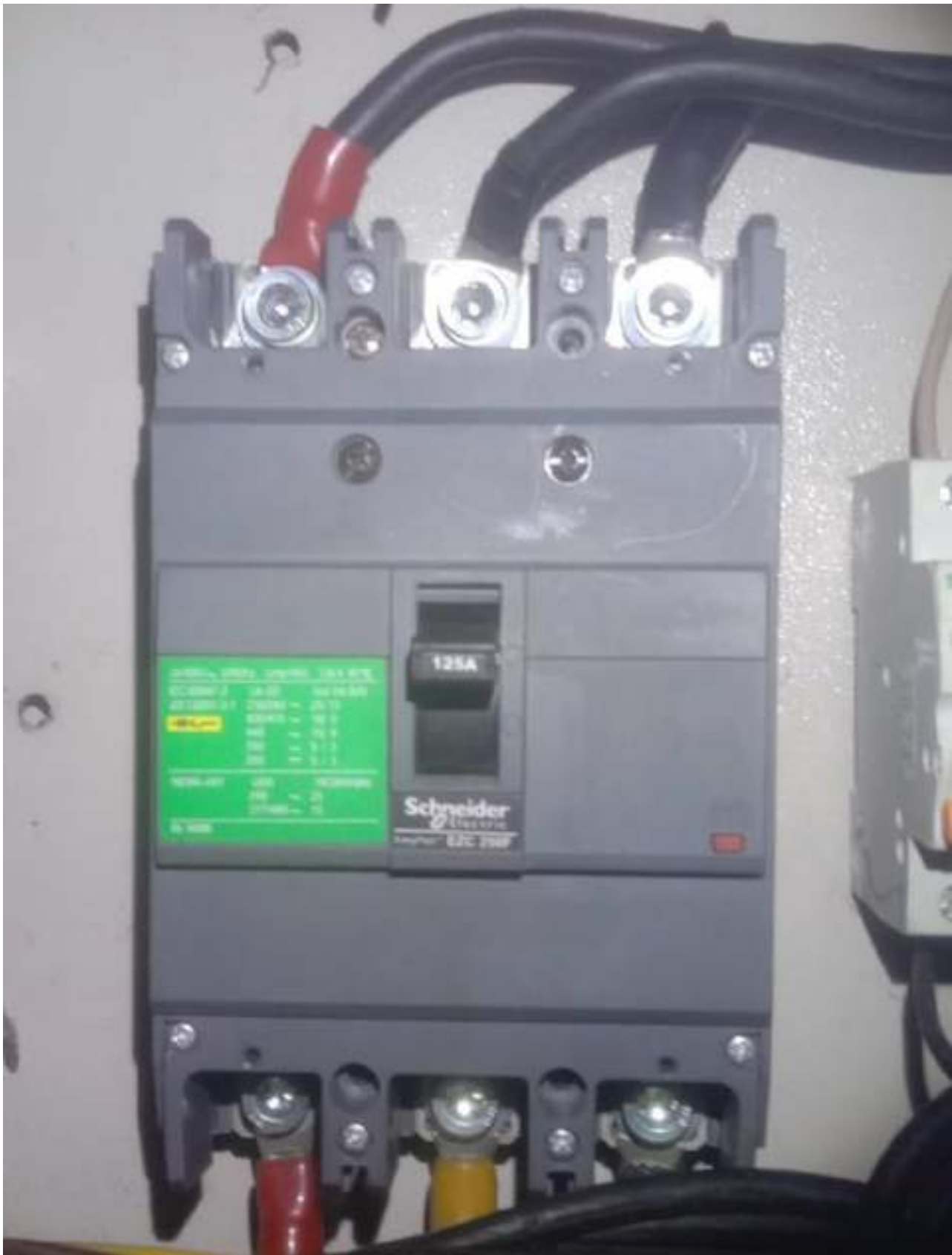
MCCB Plaza Umar Kayam sudah diganti menjadi 125 A
