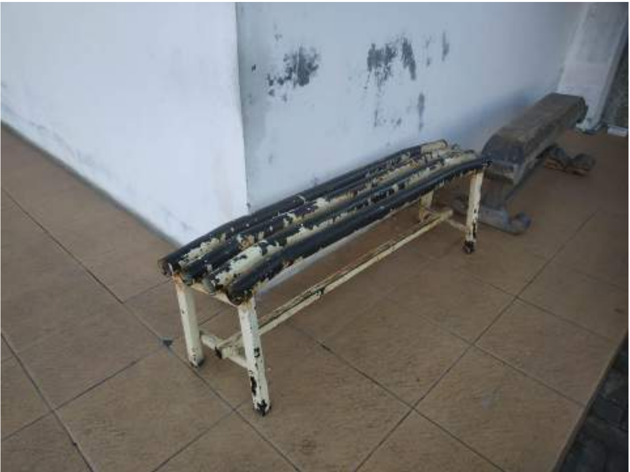
Kondisi cat meja dan kursi besi sebelum dilakukan pengecatan ulang
