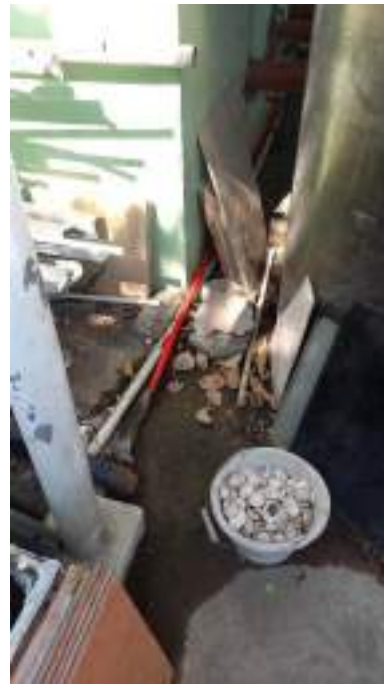
Drainase Air Dibuang Keluar Rumah Pompa Hydrant
